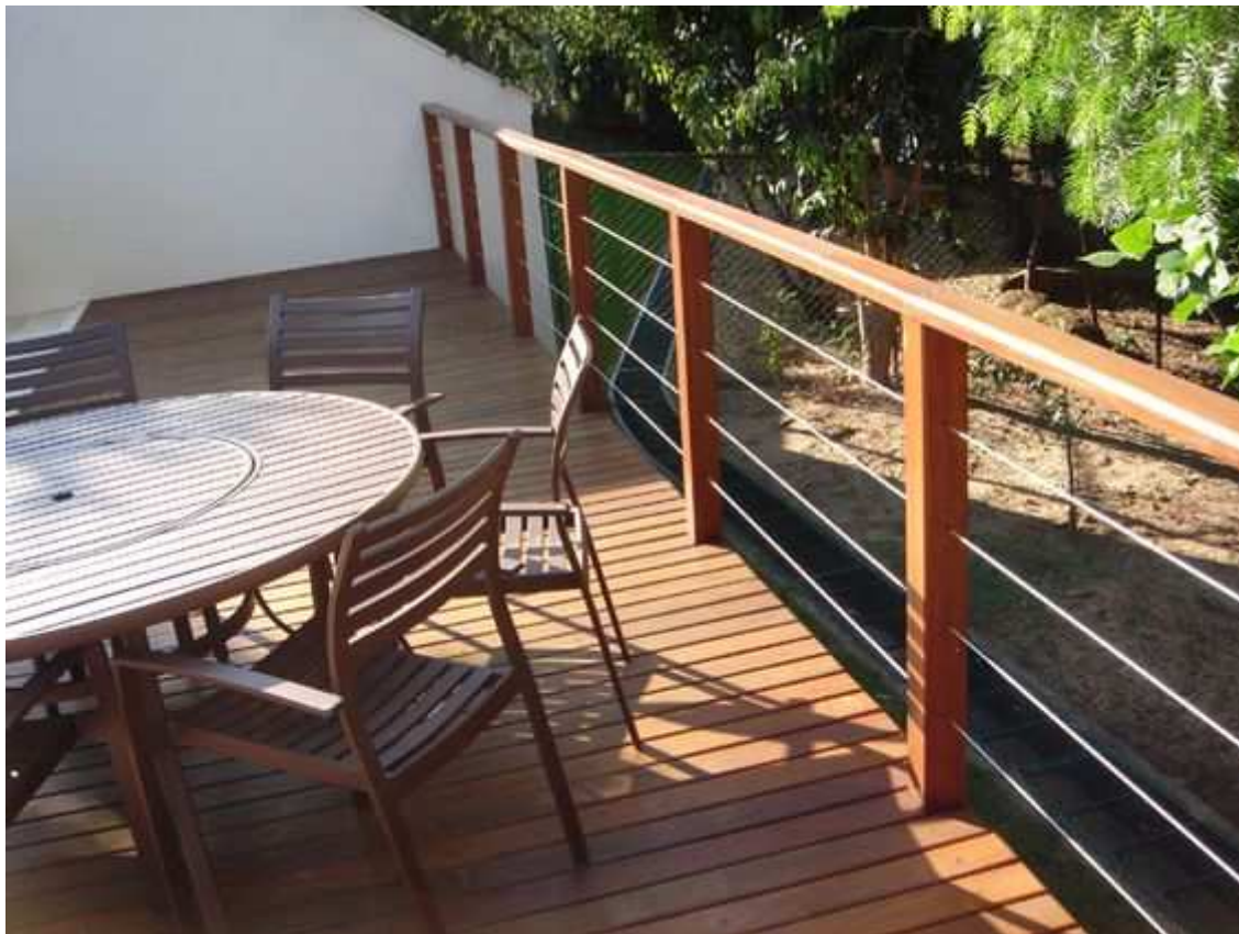
Figura 23 - Exemplo de Guarda Corpo com estrutura de madeira e cabo de aço.
